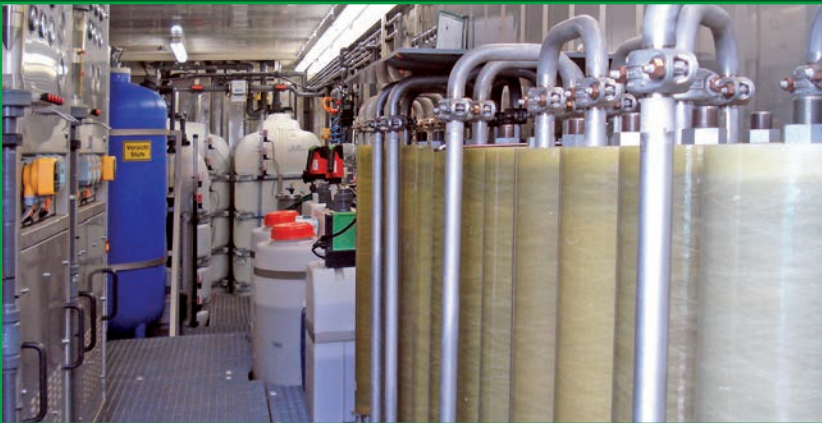
Verfahrensraum der Umkehrosmoseanlage (im Vordergrund die ST-Membranmodule)
