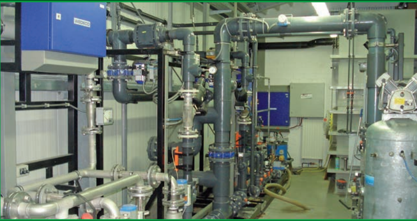
Maschinenraum der biologischen Sickerwasserbehandlungsanlage (Festbettbiologie mit nasschemischer Oxidation)
